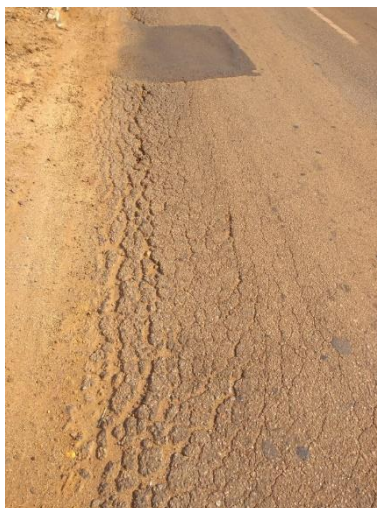
Figura 8 -Trincas couro de jacaré
