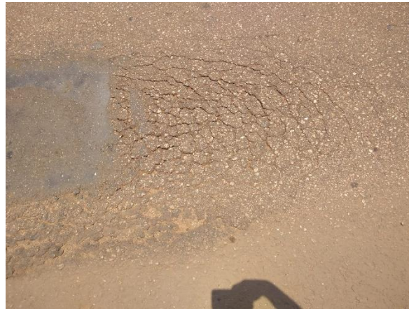
Figura 12 – Panela com trincas.
