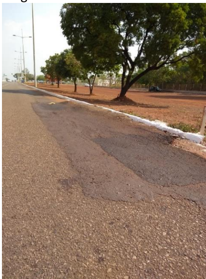
Figura 9 - Remendo com escorregamento da mistura asfáltica.
