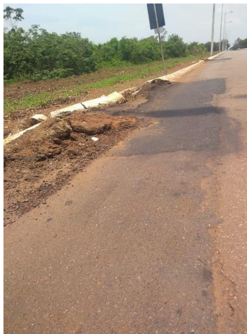
Figura 14 -Escorregamento de revestimento
