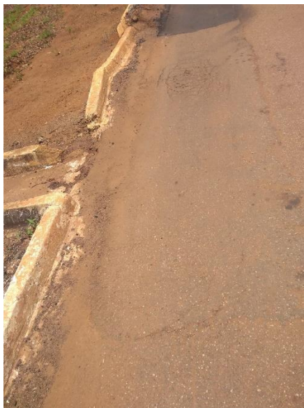
Figura 15 – Desnível da canaleta
